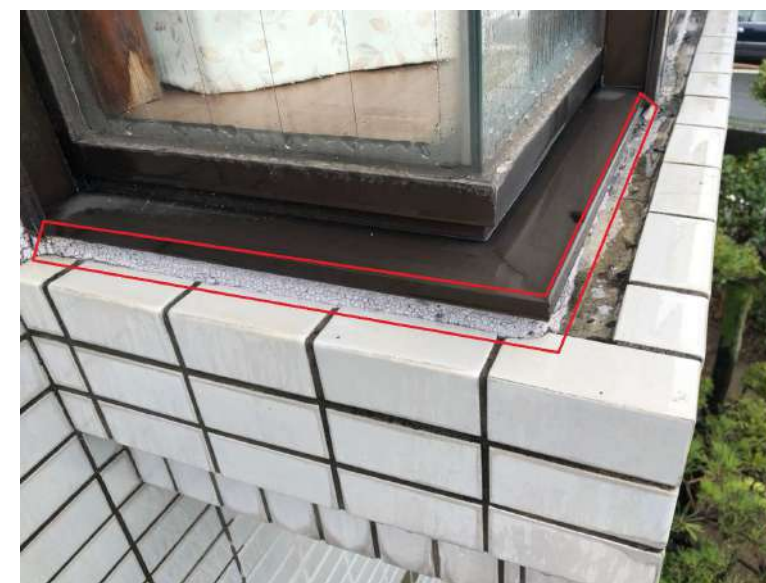
サッシ廻りの シーリングの劣化
