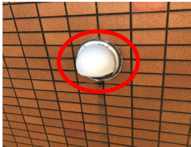
貫通部まわりの シーリングの劣化
