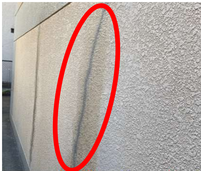
以前補修した箇所から ブリード現象が発生
